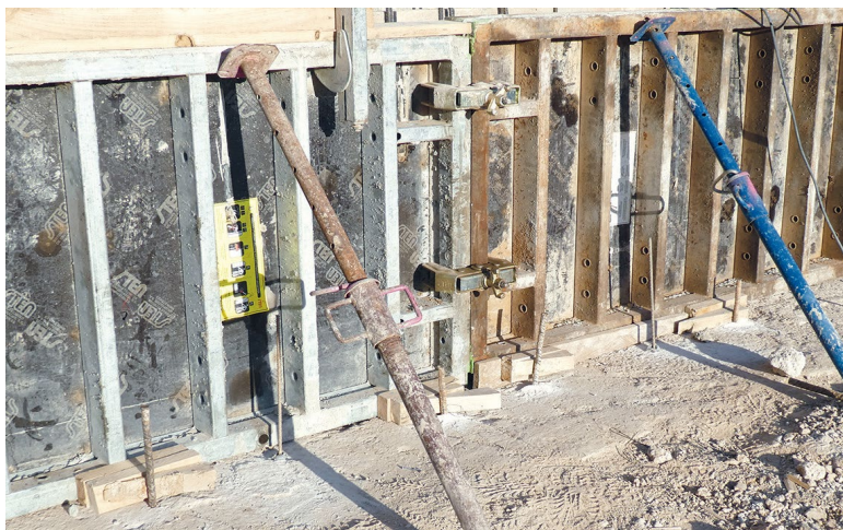
Imagen 2. Ejemplo de fijación de la parte inferior del encofrado de un murete con hormigón fluido.
