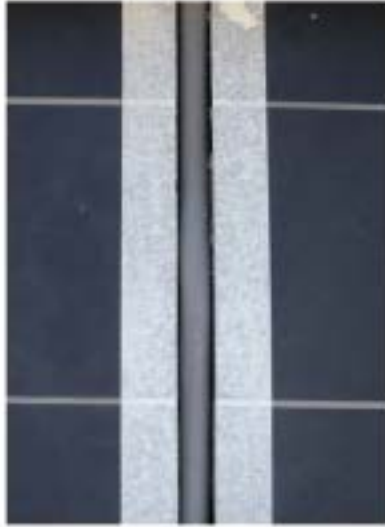
Fondo de junta (cilindro gris) antes de sellar El encintando con papel es para no manchar
