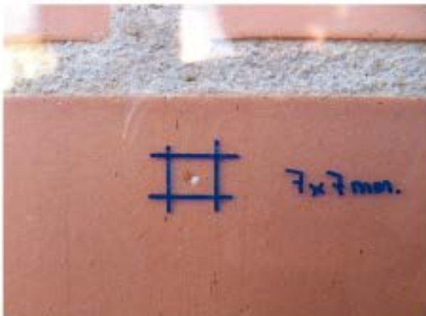
Caliche en ladrillo
