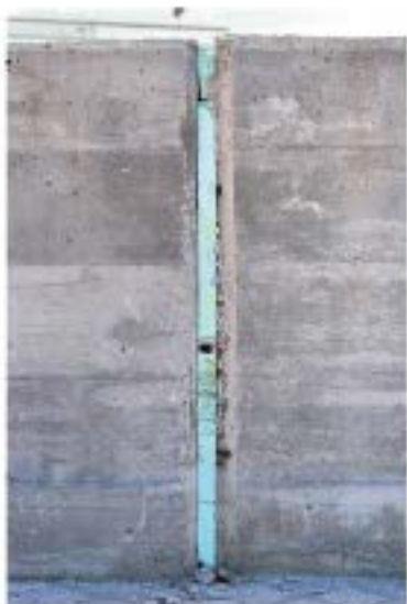
Junta de dilatación estructural en muro Se ha formalizado con poliestireno extrusionado
