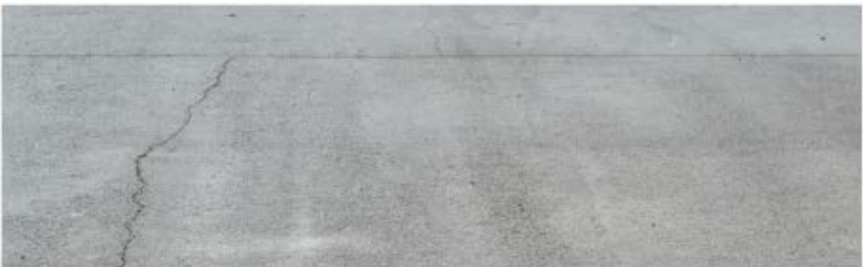
Fisura de retracción en pavimento continuo de hormigón. La línea superior de la foto es una junta de retracción o contracción
