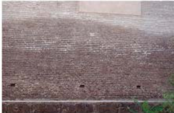
Eflorescencias debidas al agua absorbida por capilaridad
