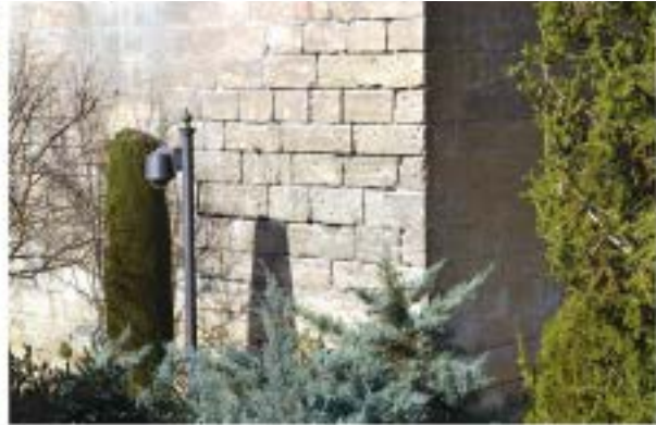
Sillares careados y bien marcados por pérdida del material de rejuntado
