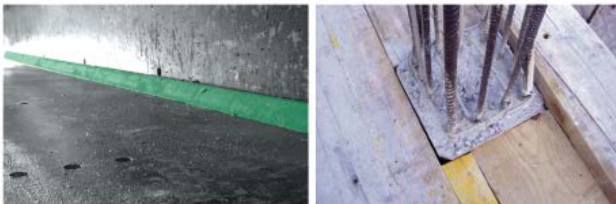
Interior de chapas de encofrado de pilar En el rincón donde se unen dos chapas está el berenjeno (verde)
