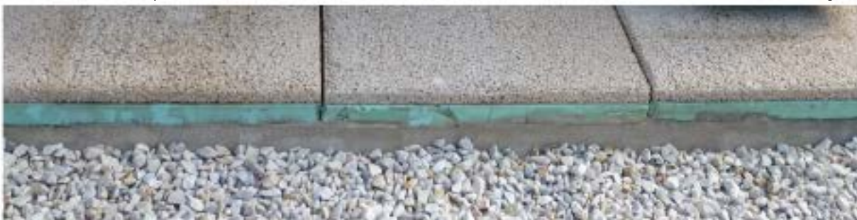
Detalle bancada con aislante (verde). La bancada es el conjunto base de hormigón + aislante + baldosas
