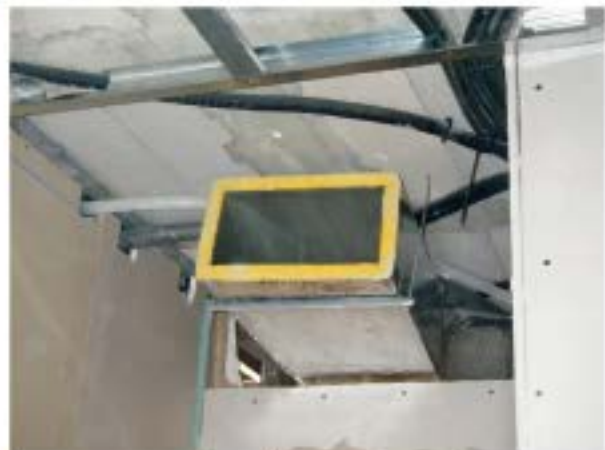
Conducto de aire acondicionado con panel termoacústico de lana de vidrio
