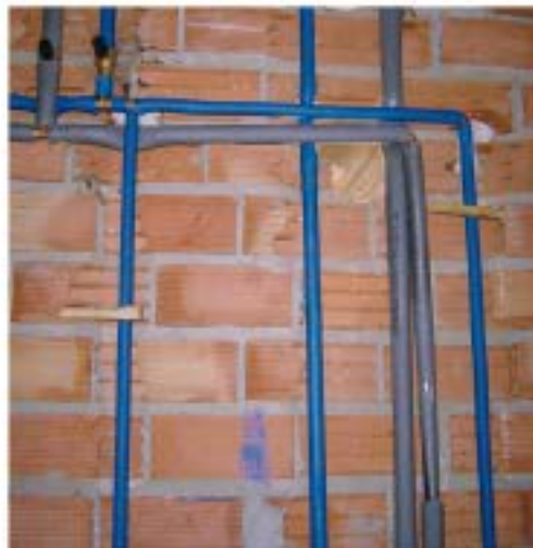
Tuberías instaladas, aisladas (gris) y protegidas (azul)
