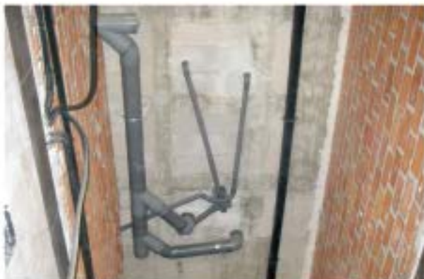
Vista desde abajo de conjunto de desagües de baño
