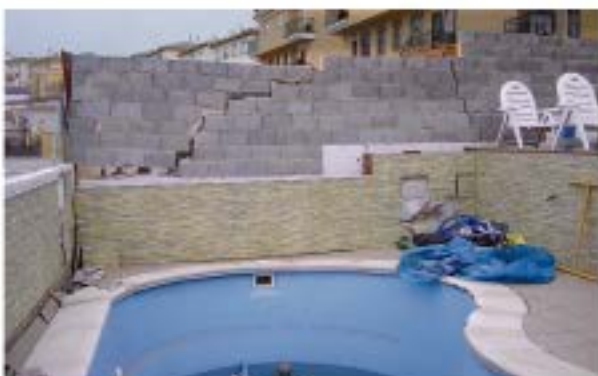
Asientos generalizados por no compactar
