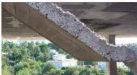
Arriba: detalle coquera puntual esquina pilar
