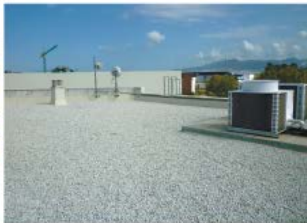
A la derecha, bancada sobre cubierta de grava
