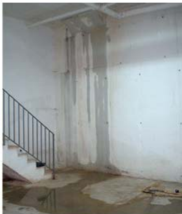
Filtración por arranque de escalera exterior, no impermeabilizada
