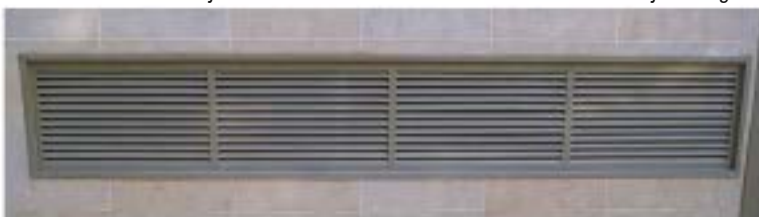
Rejilla de lamas para ventilación de semisótano
