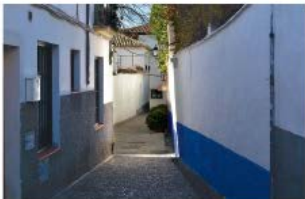
A la derecha (azul), muro desplomado
