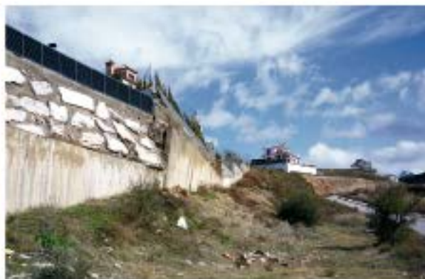
Muro de hormigón muy desplomado
