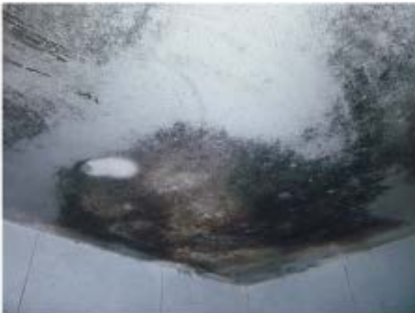
Detalle brutal condensación en falso techo de baño
