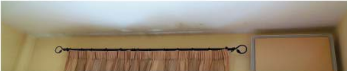
Condensación en puente térmico unión cerramiento con techo
