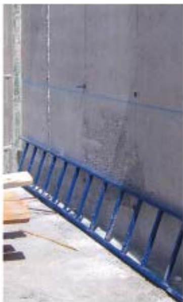
Nido de grava en muro
