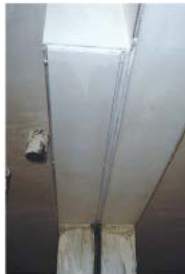
Junta de dilatación estructural incorrecta Está bien perfilada, pero hay invasión del yeso
