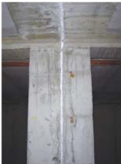
Junta de dilatación estructural en pilares y forjado Se ha formalizado con poliestireno expandido
