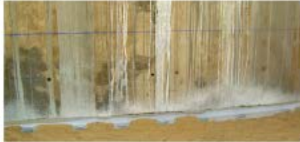
Manchas de escorrentía en muro
