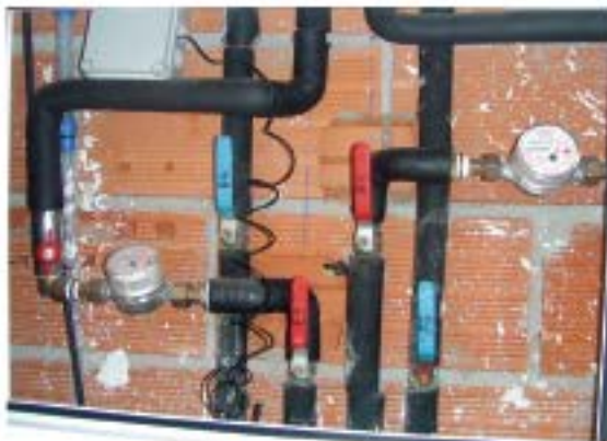
Interior de un patinillo instalado
