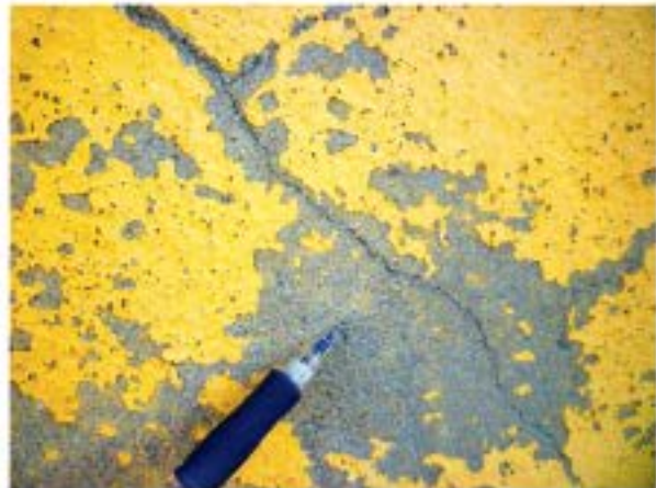
Detalle fisura típica de retracción por afogado: superficial y de escasa abertura (arriba: efecto desertización)
