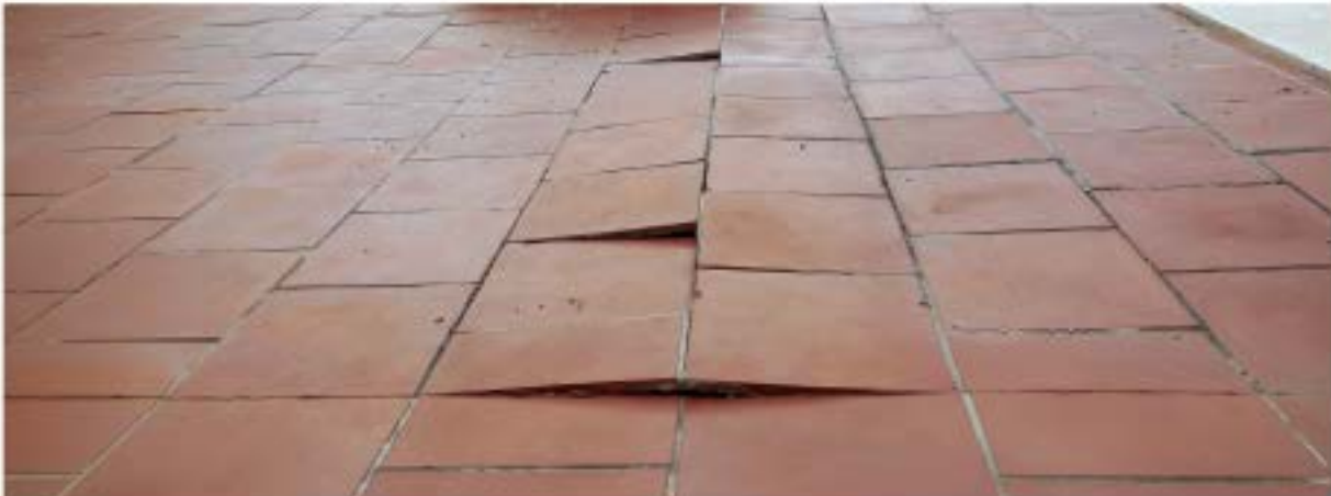
Levantamiento en "tienda de campaña" por omitir junta o por construirla deficientemente
