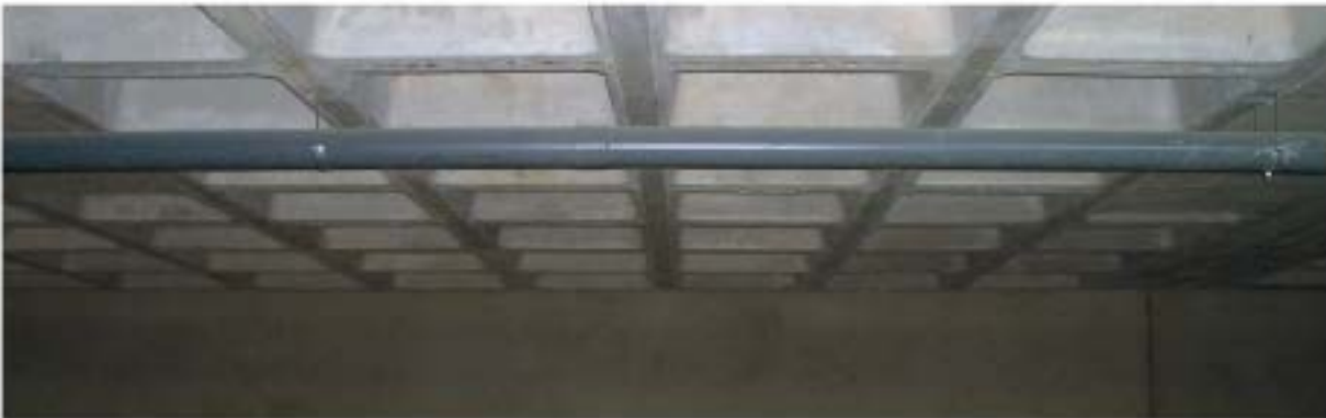
Colector colgado incorrectamente (horizontal = sin pendiente )
