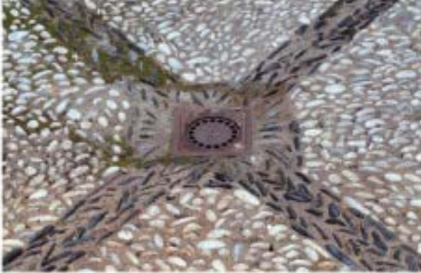
Sumidero-desagüe de fundición
