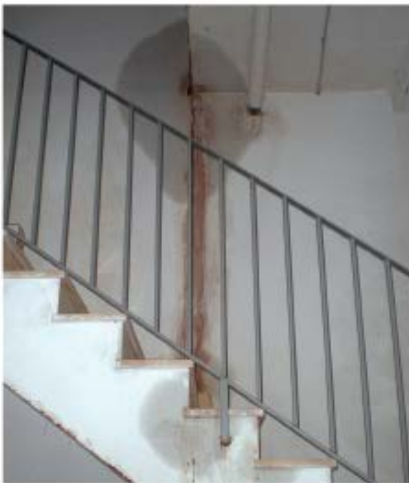
Filtración por junta de dilatación
