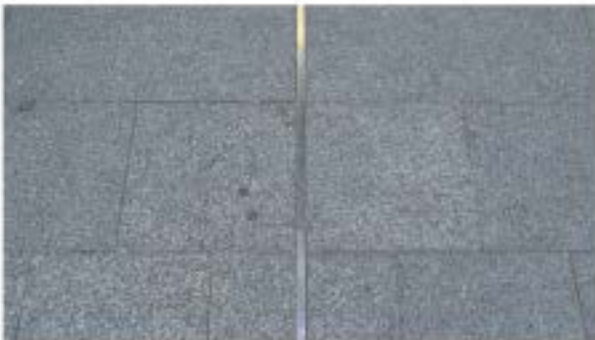
Junta de dilatación en suelo, con tapajuntas
