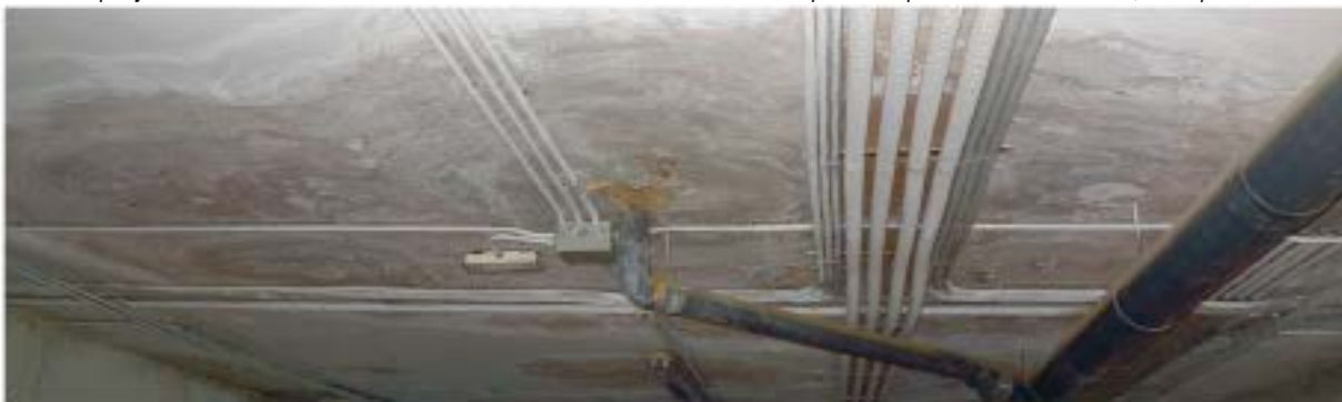
Filtración masiva por techo de sótano
