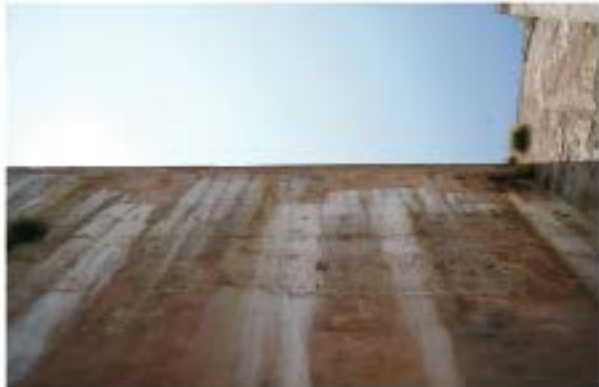
Eflorescencias debidas al agua de escorrentía tras filtración
