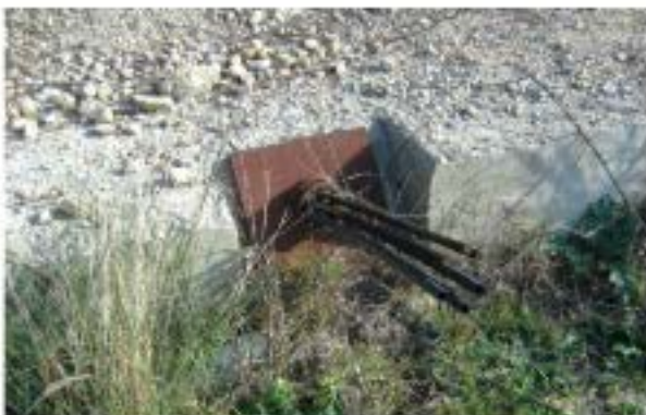
Cabeza de anclaje de un terreno a través de elemento de hormigón
