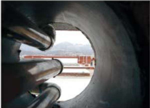
Pasamuros en pared para grupo de tuberías
