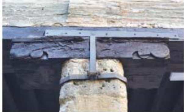
Abrazadera en cabeza de pilar de piedra para evitar desplazamiento
