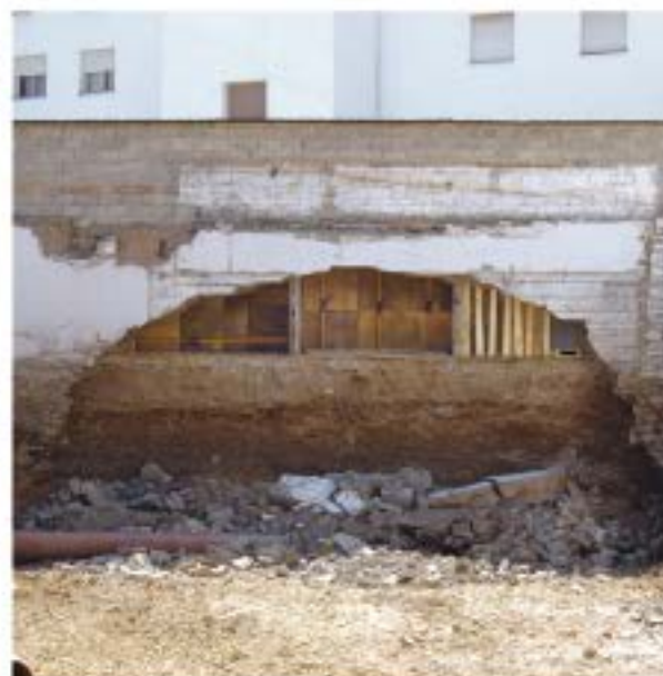
Colapso por asiento en el centro del arco (se denomina "arco de descarga")
