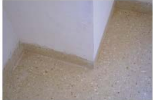
Resultado desigual al colocar todo en el mismo plano, cuando la pared no es plana
