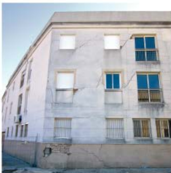
Importante afectación por asentamientos diferenciales
