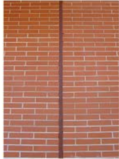
Junta de dilatación constructiva terminada El sellante es específico para juntas de dilatación
