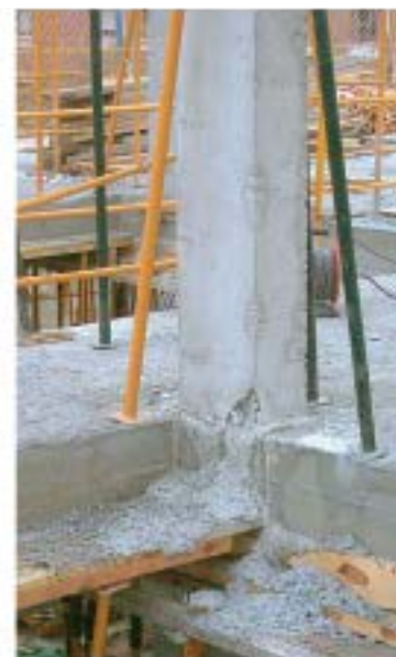
Importantes pérdidas en base de pilar
