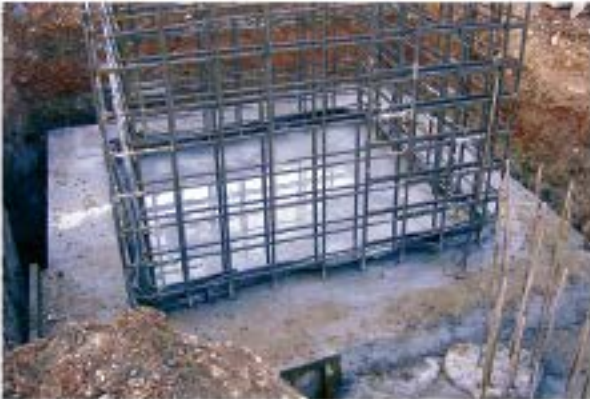
Cinta de pvc colocada en la junta de arranque de un futuro foso
