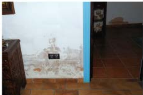
Humedad capilar en un tabique por la presencia de agua bajo la solería
