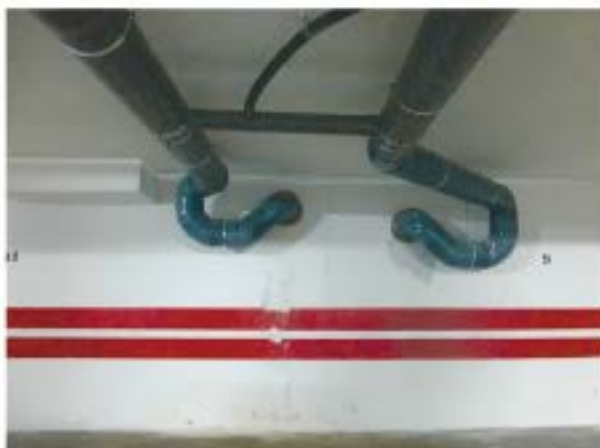
Grandes sifones instalados a la salida del saneamiento a su acometida
