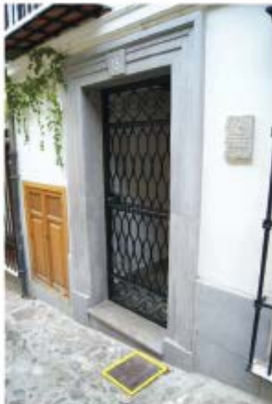
Acometida de telecomunicaciones
