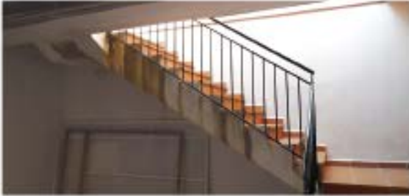
Manchas de escorrentía en canto de escalera
