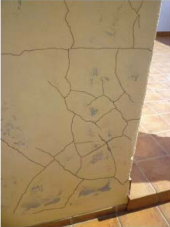
Mapa de fisuras en escama o piel de cocodrilo
