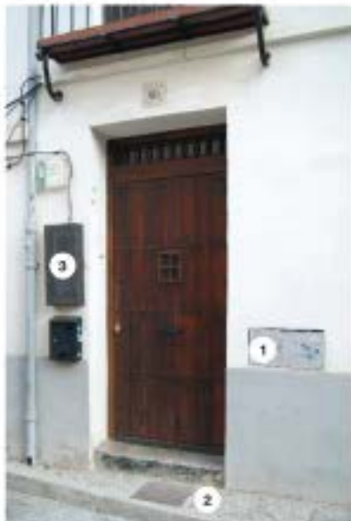
Agua (1), saneamiento (2) y electricidad (3)
