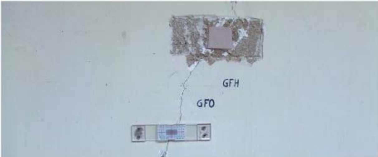
Testificación de fisura: abajo, extensímetro; arriba, testigo de yeso
