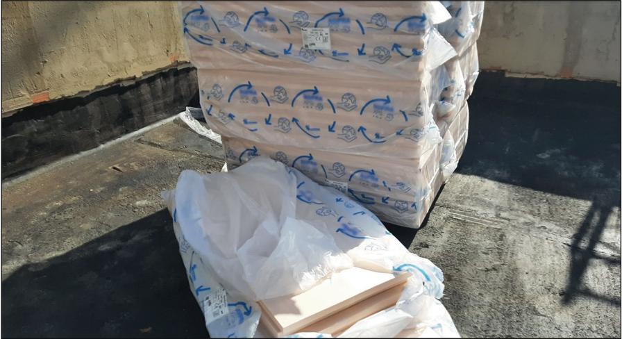
-Imagen B- Desembalaje de los paquetes con paneles de aislamiento de poliestireno extruido.
