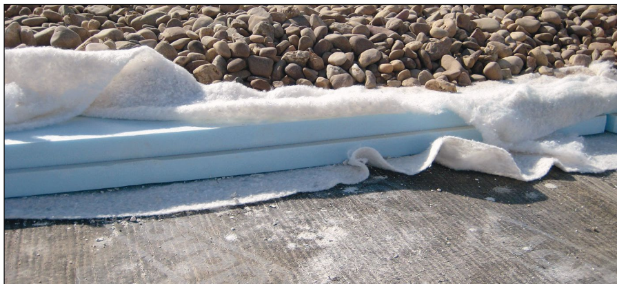
-Imagen L- Vista de la colocación de un geotextil por encima y por debajo del panel aislante de poliestireno extruido, formando respectivamente la 1ª y 2ª capa separadora.
