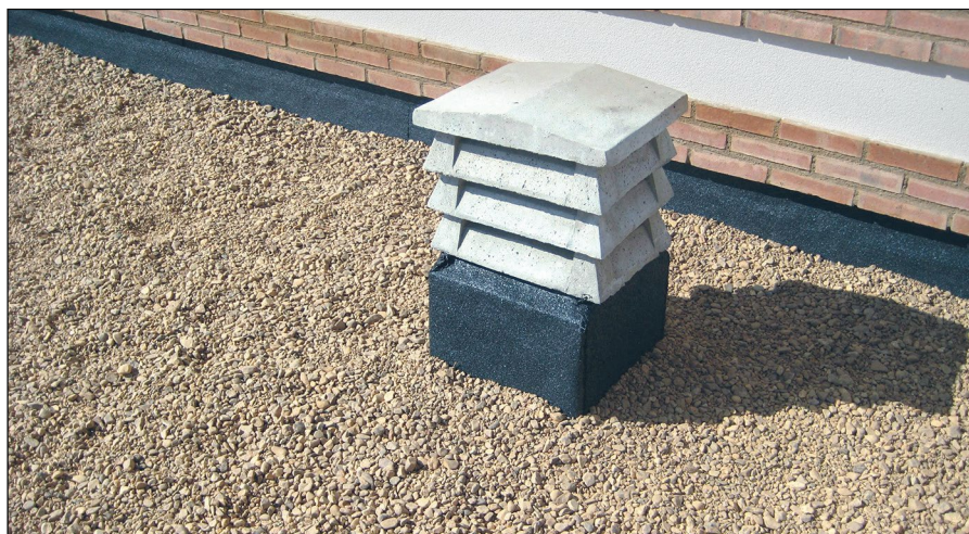
-Imagen N- Cubierta plana totalmente acabada y con la grava de río extendida superficialmente.
