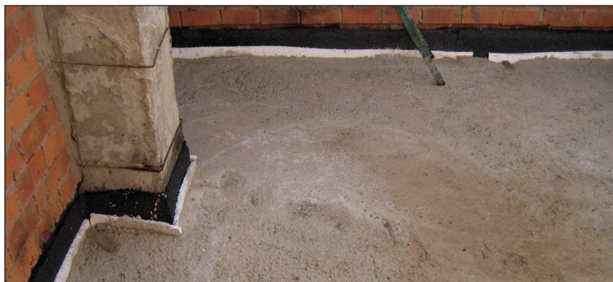
-Imagen G- Tendido de regularización de mortero de cemento ya extendido y fraguado.
