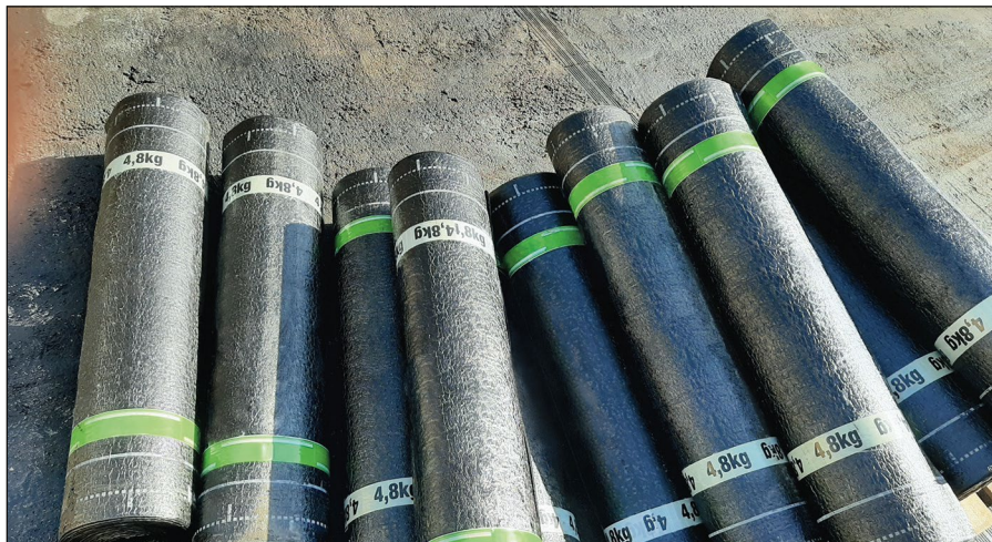
-Imagen A- Vista del acopio de distintos rollos de láminas de betún antes de su colocación.
