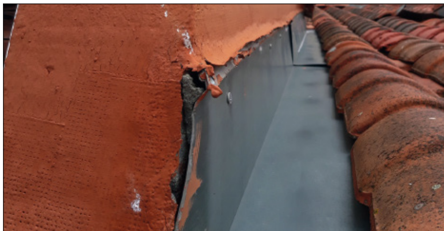
-Imagen D- Encuentro con un paramento vertical mediante la interposición de una canal lateral metálica. En este caso, debería tener más altura de protección y un mejor sellado de coronación.
