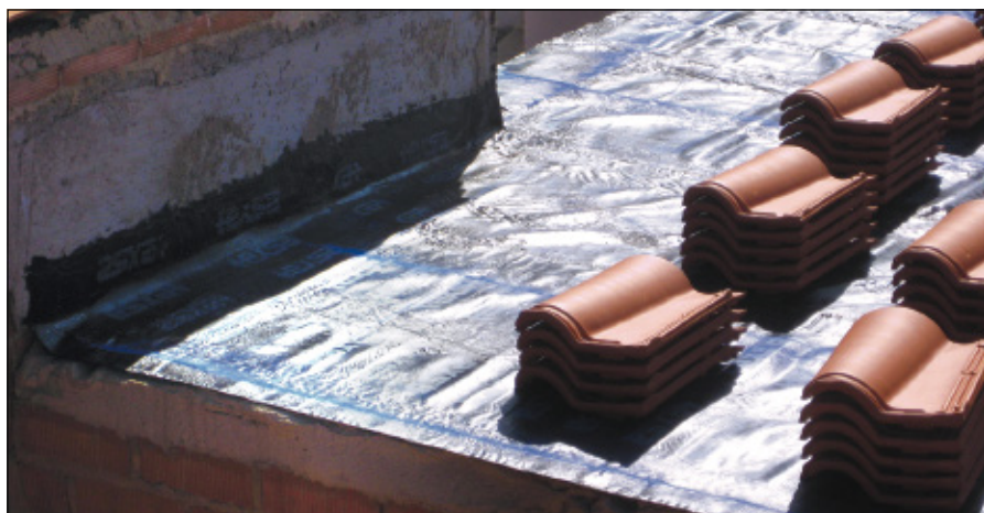
-Imagen I- Colocación de una lámina impermeabilizante en un faldón de cubierta con poca pendiente. Falta por disponer otra capa sobre dicha lámina antes de colocar las tejas.
