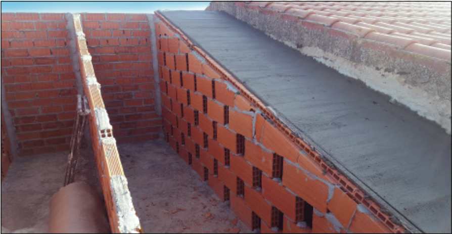
-Imagen G- Vista de la realización de la capa de compresión en una de las calles de la cubierta.
